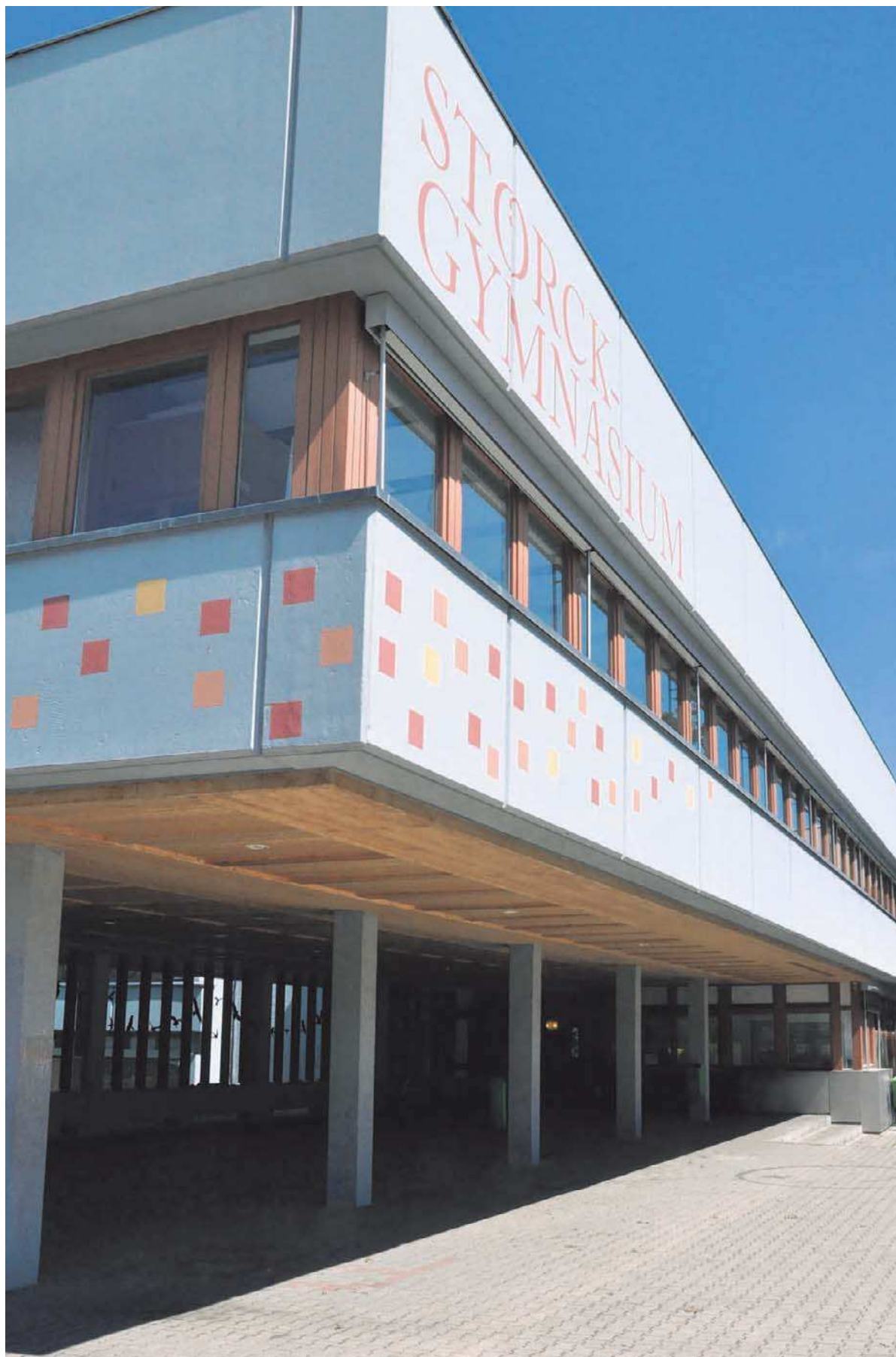
Im Störck-Gymnasium Bad Saulgau wurden bei Routinemessungen PCB-haltige Fugen festgestellt. Es gibt keinen Grund zur Panik, aber es besteht Handlungsbedarf. In den Ferien muss dringend saniert werden. ARCHIVFOTO: RUM
